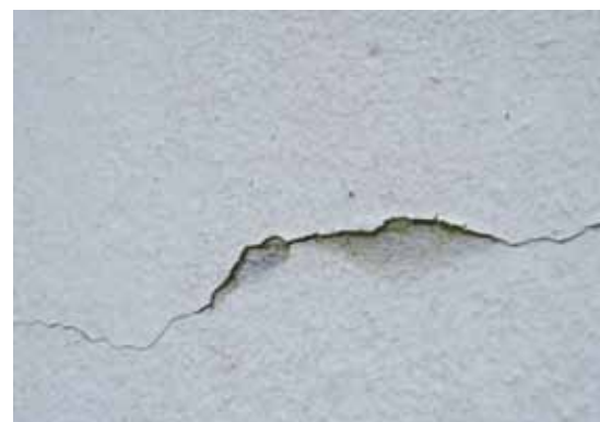
Décollement / fissuration du crépi
