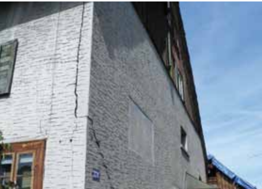
Fissures dans un élément de construction
