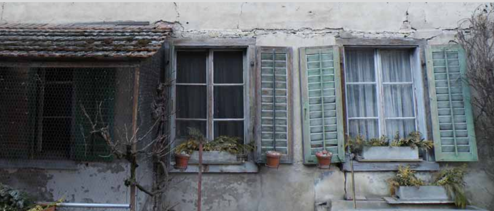
Façade avec fissures
