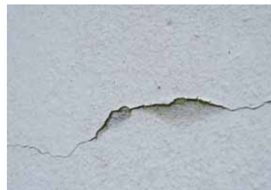
Décollement / fissuration du crépi
