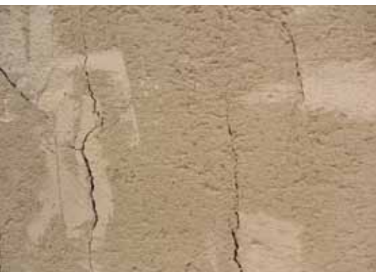
Fissure de retrait sur la couche fraîche
