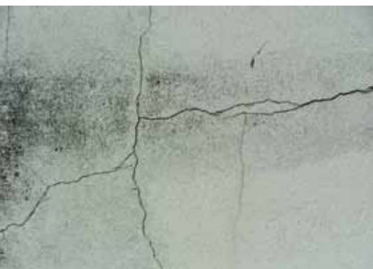
Fissure de retrait sur la couche solidifiée
