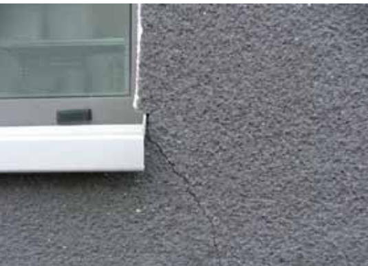
Fissures aux angles des ouvertures
