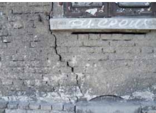
Risse im Bauteil
