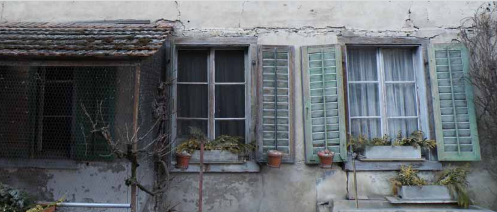
Fassade mit Rissen
